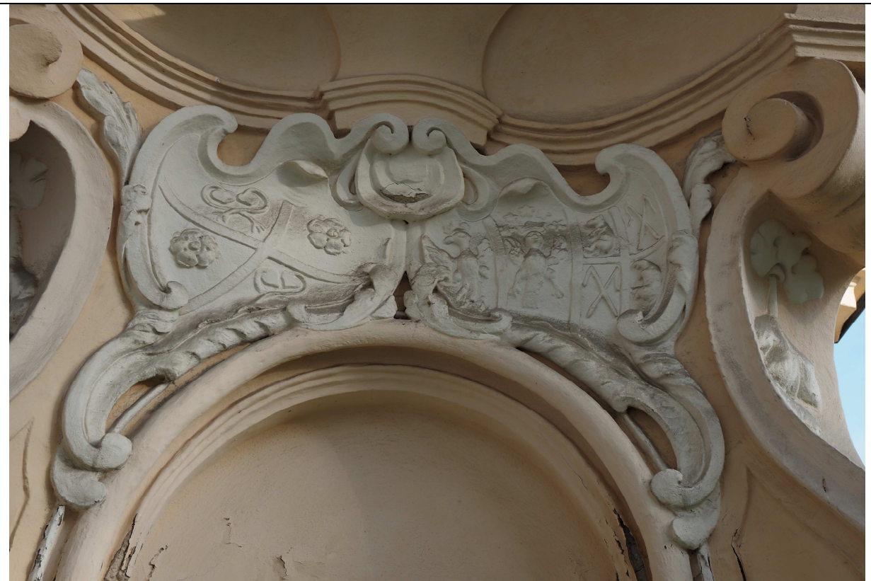
Erby v katuších bez zjevných poruch pod souvrstvím mladších nátěrů.
