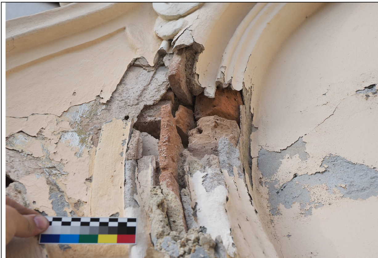
Degradovaná profilace rámu oválného zrcadla.
