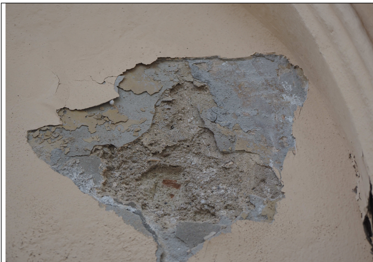
Omítka v zrcadle je převrstvena cementovou stěrkou se souvrstvím nátěrů.
