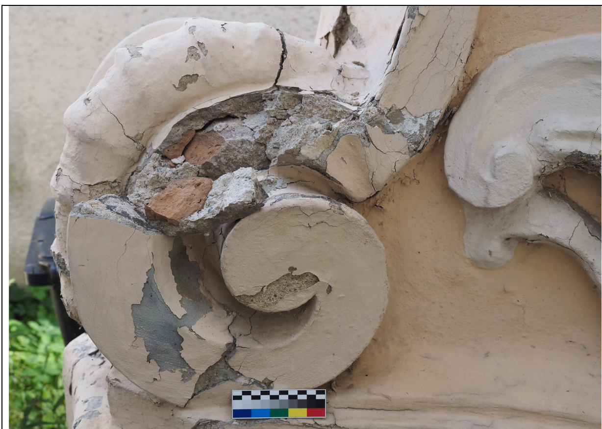
Degradované cementové tmely včetně cihlového zdiva.
