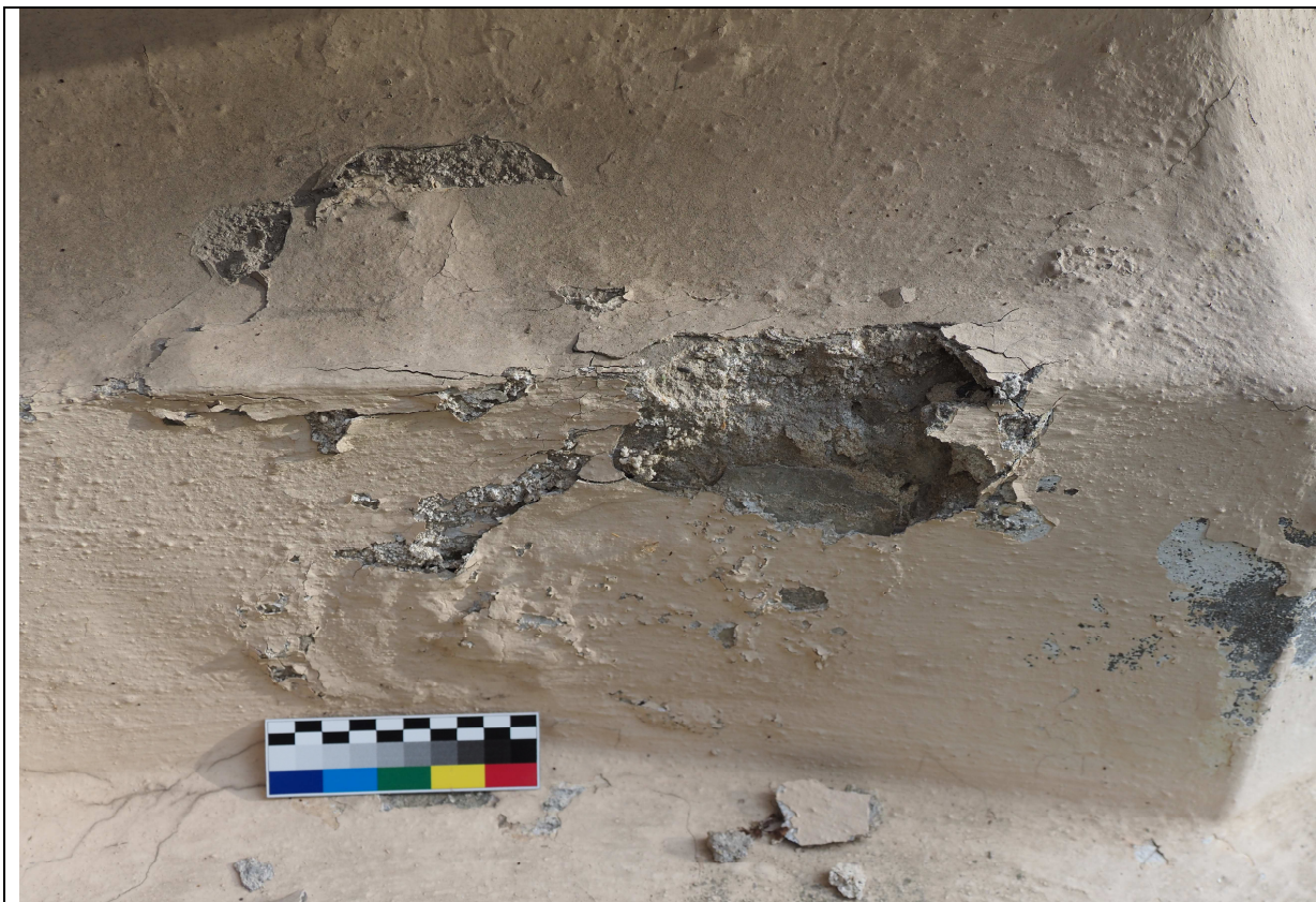
Destrukční projevy vodorozpuštěných solí.
