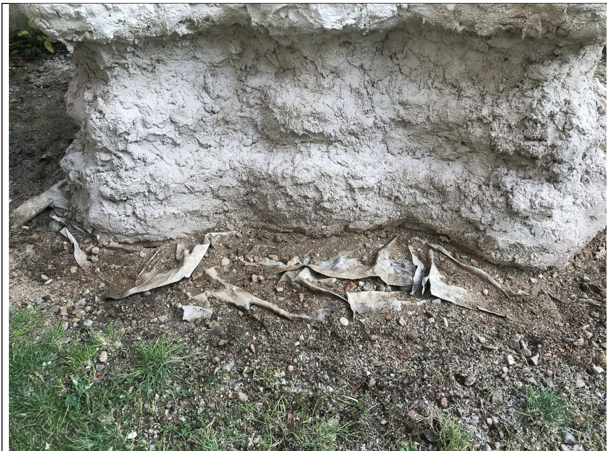
Pata stavby po odstranění zásypu z kačírku s patrným nefunkčním odvodněním.
